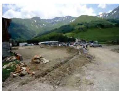
Foto nr. 18. Ndërtimet ilegale në Prevallë
