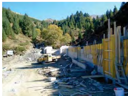
Foto nr. 109. Degradimi i shtratit të lumit Berovec
